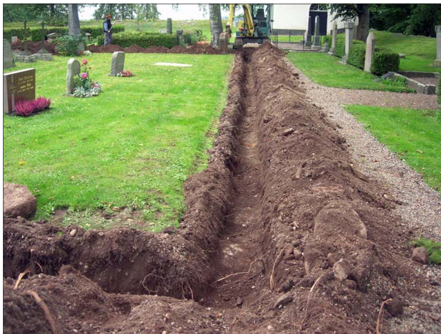
Figur 4. Schakten för dräneringsrören var förhållandevis grunda. Foto mot N Christer Carlsson, ÖLM.
